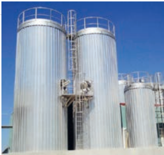
réservoirs en acier inoxydable réservoirs destinés au silo
